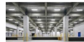
LED照明の導入
